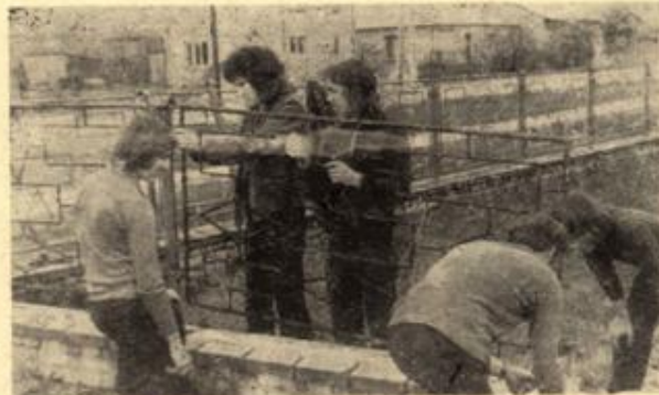
Uczniowie szkół przyzakładowych, jak ci z ZSE przy Kombinacie Ciepłownym „Chelm”, wykonują w ramach czynów społecznych wiele pożytecznych prac, m. in. sprzątanie, niekiedy także do wyposabiania pracowni itp. Na przykład uczniowie z Chelma społecznie wykopali oraz wartości ponad 30 tys. zł.
